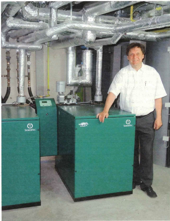
Produziert ein Viertel seines Strombedarfs selbst: Hubert Drayer mit seinen beiden BHKW im Keller vom Landgasthof Michels
